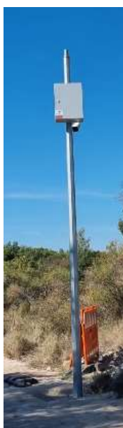
Slika 7. Primjer stupa za smještaj kamere sa solarnim napajanjem
